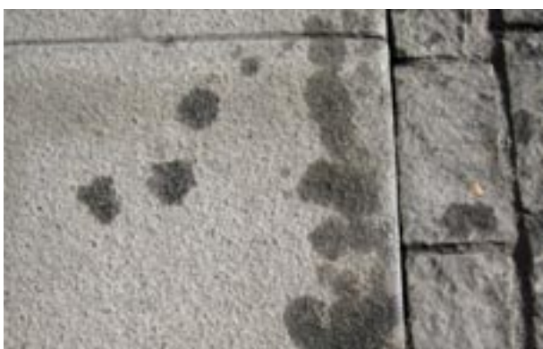
Fig 11.4 Misspdydande oljefläckar på granitramsten.
