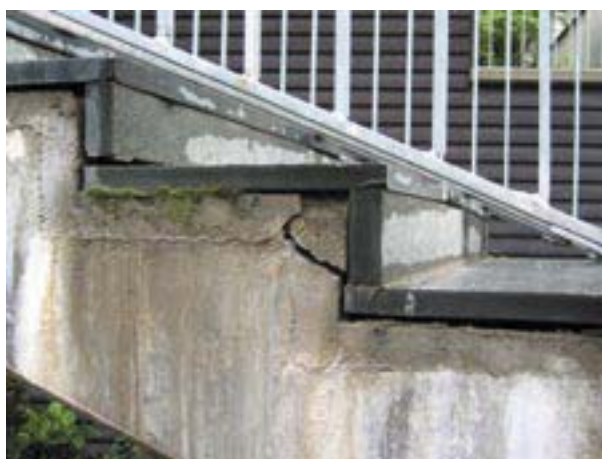
Fig 7.33 Frost- och saltsprängning av läggbruket i trappa med plan- och sättsteg.
