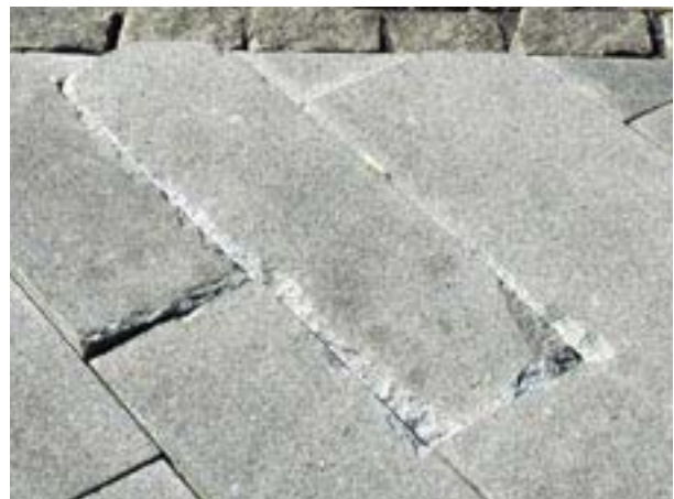
Fig 4.37 Granitbeläggning där plattkanterna har spjälkats ut. Smala fogar och alltför tung trafik i förhållande till underbyggnaden är troliga orsaker.
